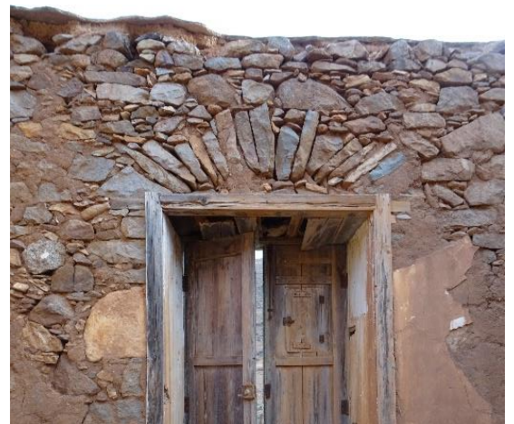
Arco de descarga que sustituye al dintel.
